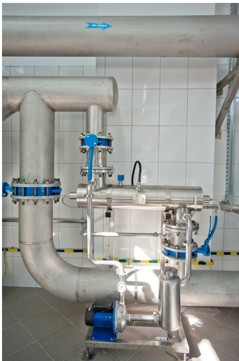
Fotografia 4. Lampa UV służąca do redukcji z wody substancji organicznych na ujęciu SUW Piaskownia w Jaworznie, ul. Bukowska 5.
