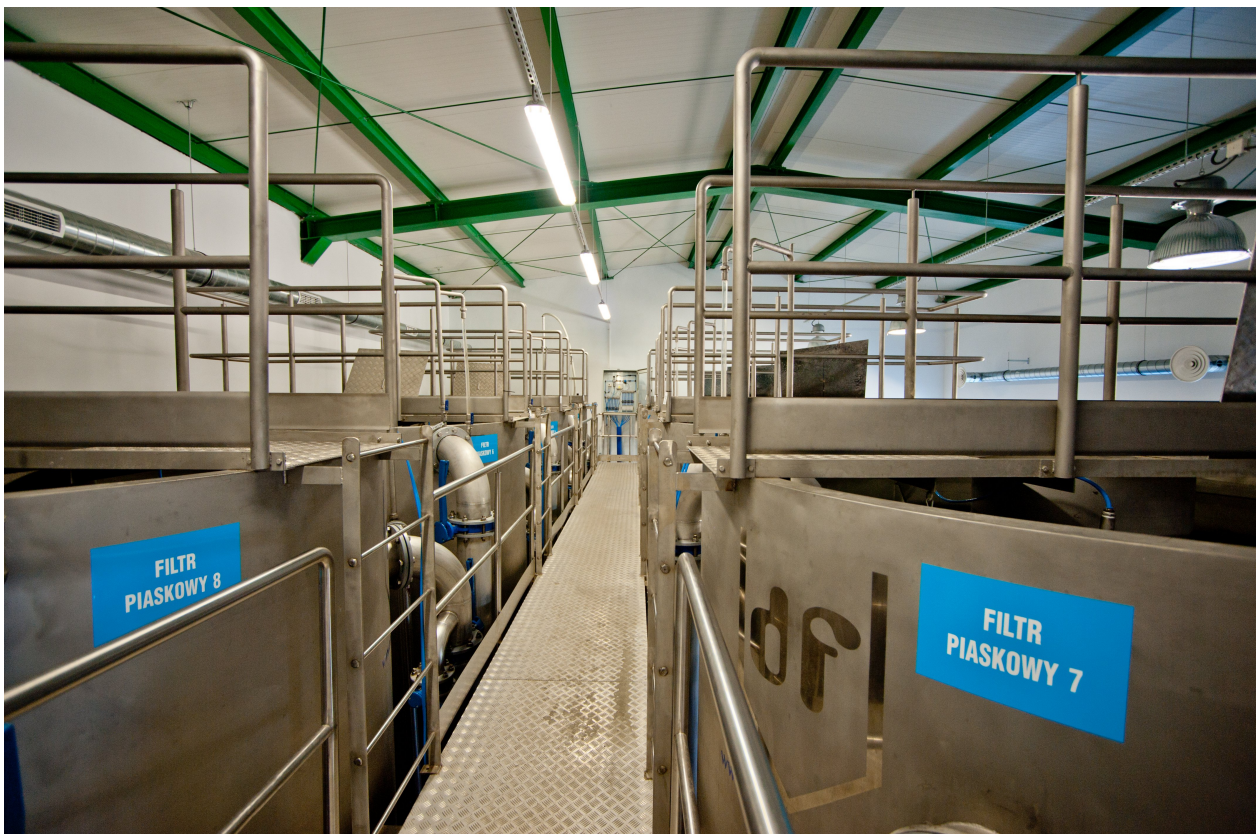
Fotografia 3. Filtry piaskowe na ujęciu SUW Piaskownia w Jaworznie, ul. Bukowska 5.
